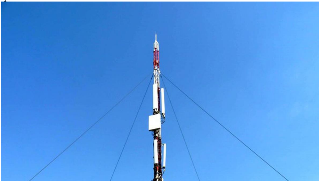
Рис.1. Антенно-фидерная конструкция базовой станции
