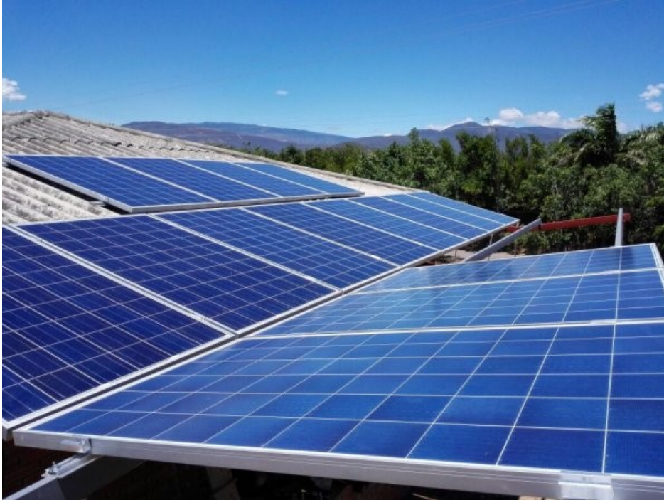
Рисунок 1.4 – Сонячна електростанція на фотоелектричних панелях
