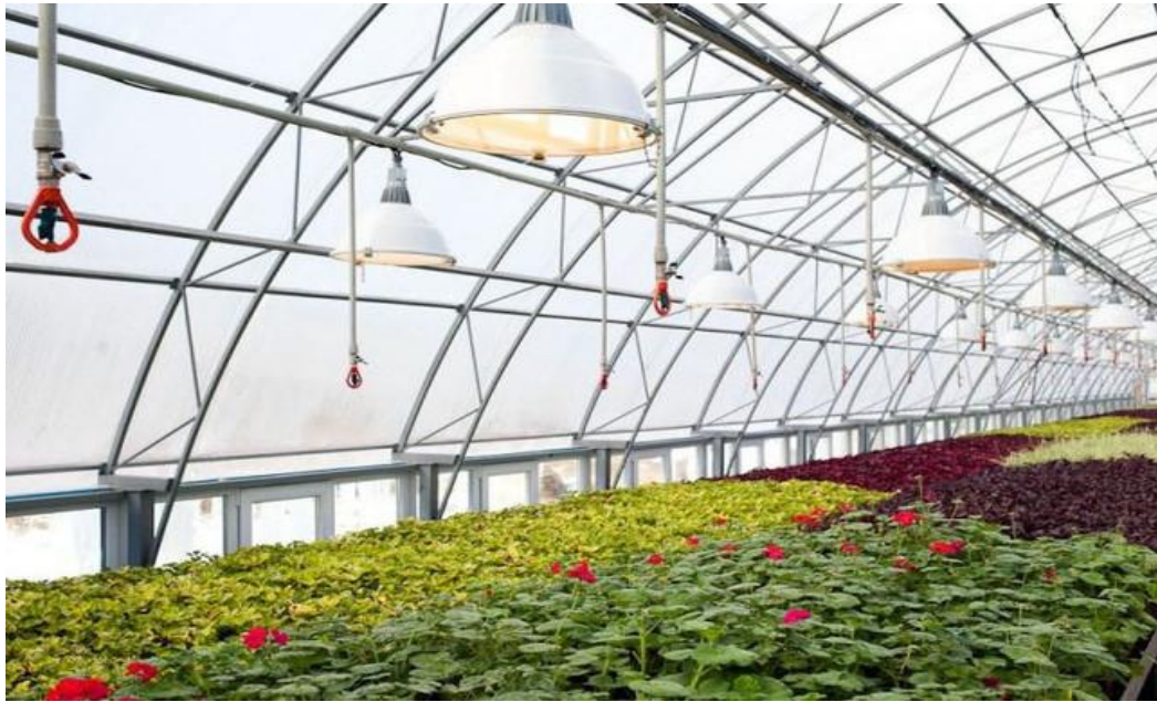
Рисунок 4.3 – Потолочне підвісне освітлення теплиці
