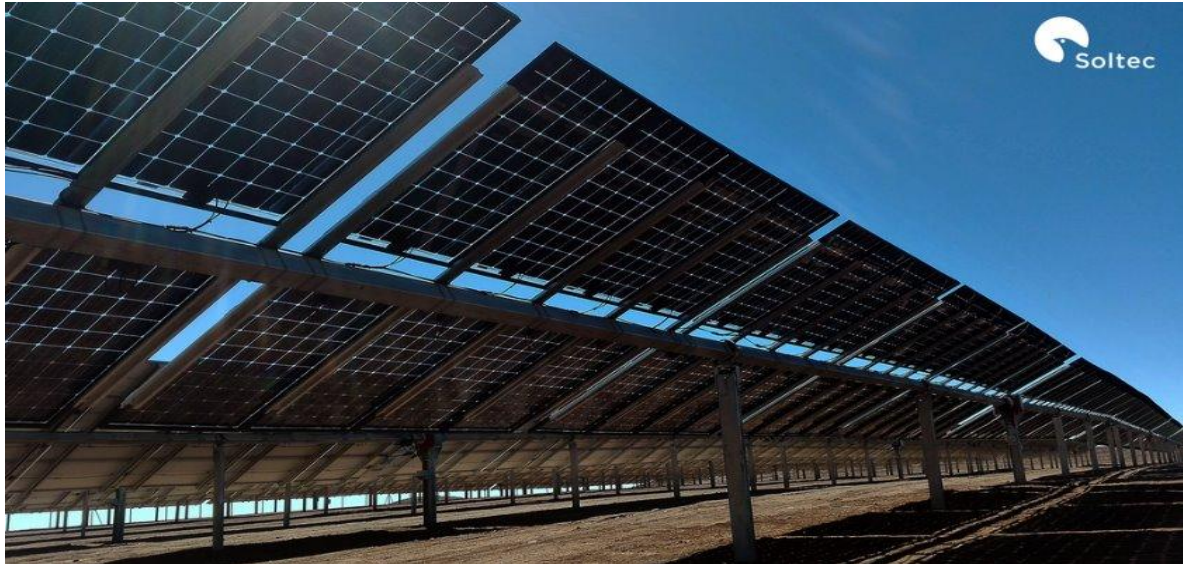
Рисунок 2.7 – Двосторонні сонячні панелі.
