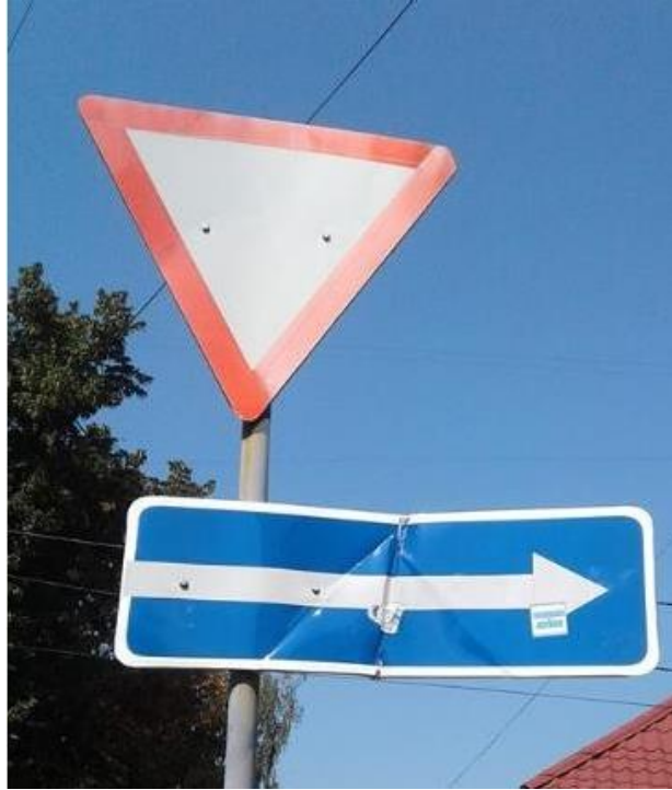
Рисунок 1.2 – Приклад деформованого дорожнього знаку
