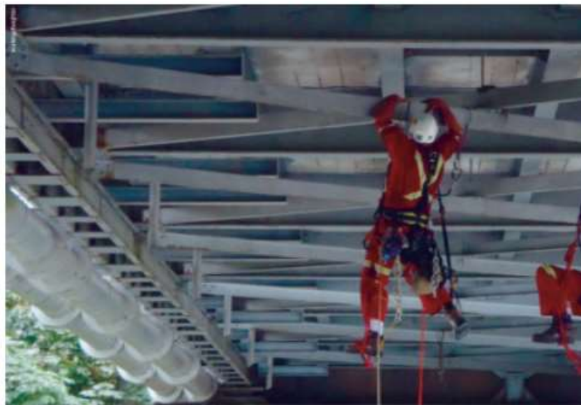
Рисунок 1.3 – Візуальний огляд під мостом
