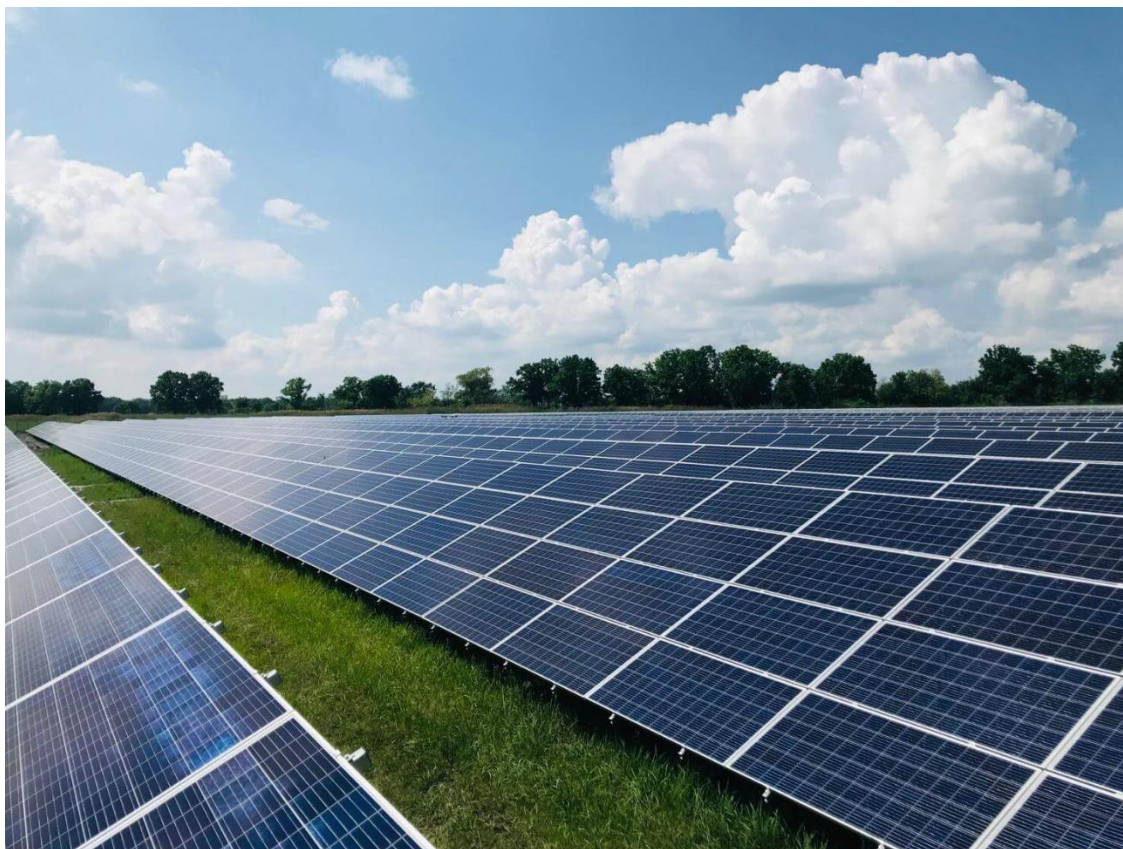
Рисунок 3 – Сонячна електростанція на фотоелектричних елементах
