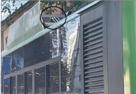
Рисунок 3 — перетворювачі, які розташовані на даху тролейбуса
