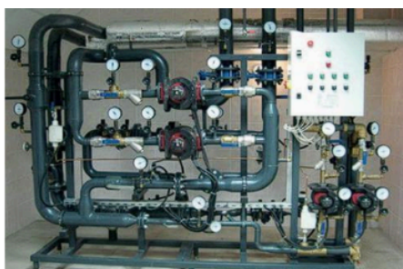
Рисунок 3 – Блочний тепловий пункт з обладнанням та приборами обліку
