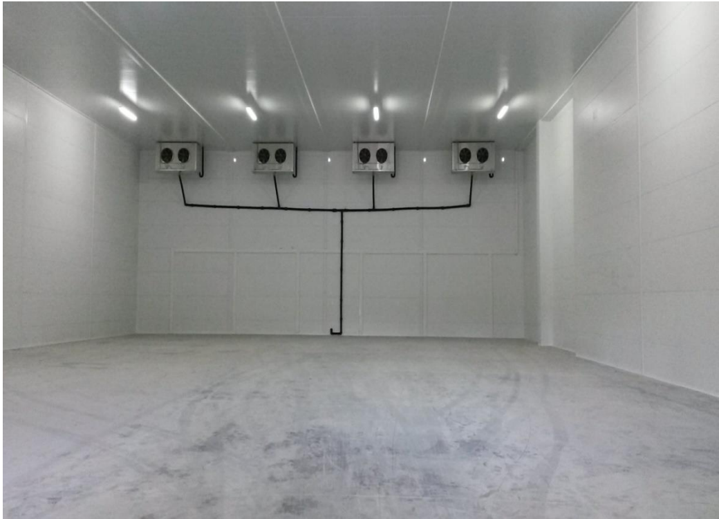
Рисунок 2.5 – Виробниче приміщення примусового холоду.
