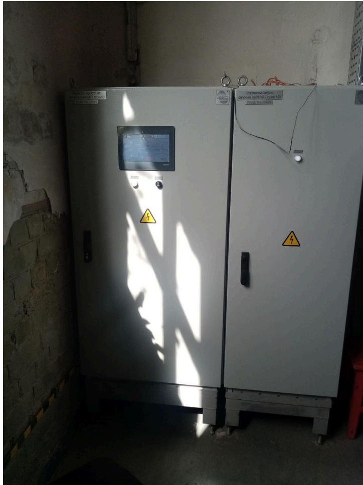
Рисунок 1.3 – Щит автоматизації на ЦТП.
