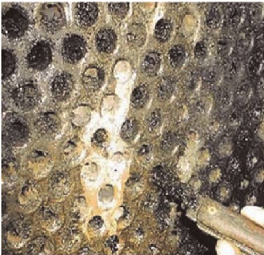
Рис.1.3 - Залишок вуглеводню в трубках теплообмінника
