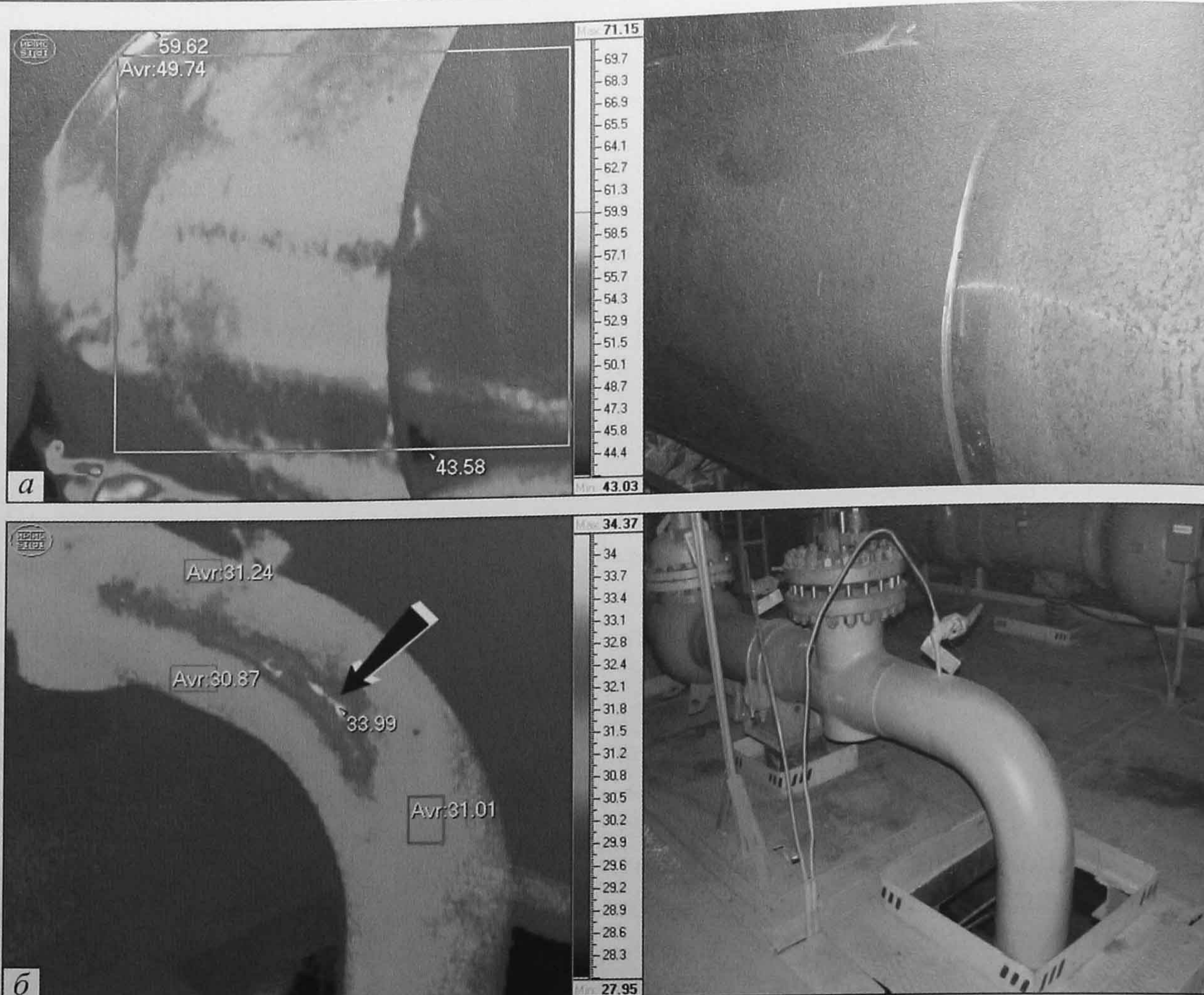
Рис. 4. Визначення стану металу на трубопроводах АЕС: ділянка паропроводу високого тиску з можливим дефектом (а); виявлена ділянка з кавітаційною ерозією (дефект потоншення стінки труби) (б)
