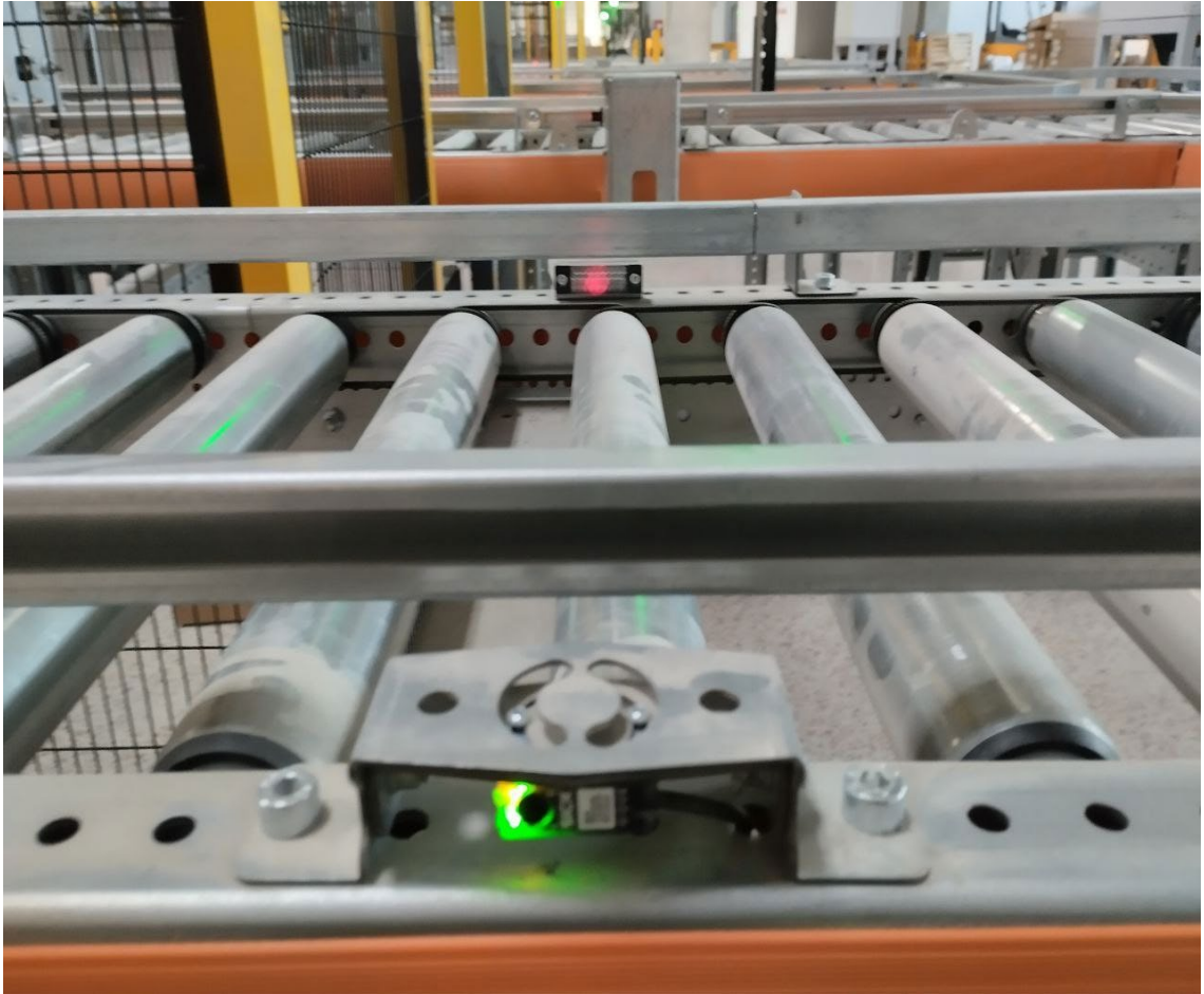
Рисунок 2.6 – Встановлення датчику на конвеєрній лінії
