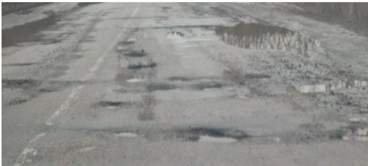
Рисунок 1 – Приклад дефектів дорожнього покриття, що можуть створювати небезпеку для велосипедистів
