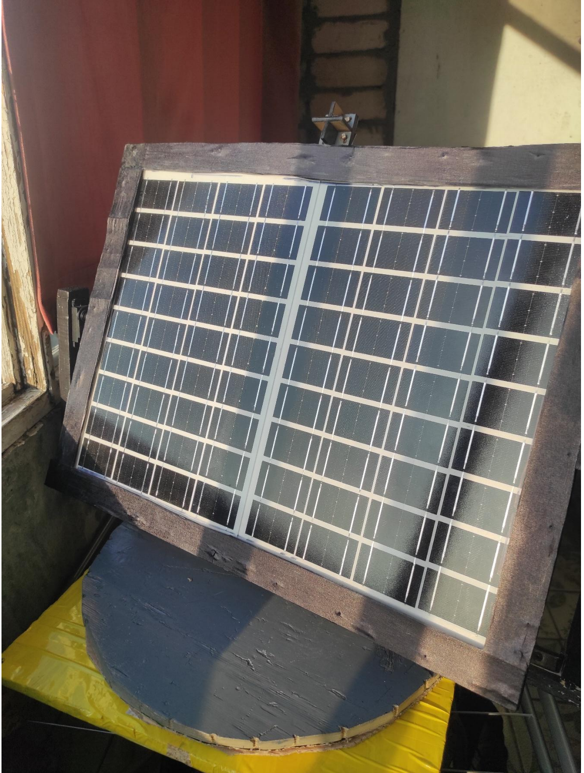
Рисунок 3.23 – Точне положення сонячних панелей
