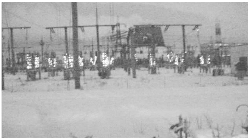
Рис. 1. Перекрытие изоляции оборудования 330 кВ
