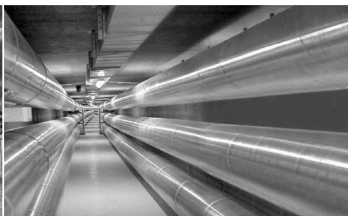
Рис. 6. ГИЛ в тоннеле
