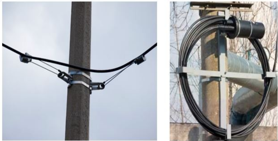
Рисунок 3.1 - Підвіс оптичного кабелю на опорах
