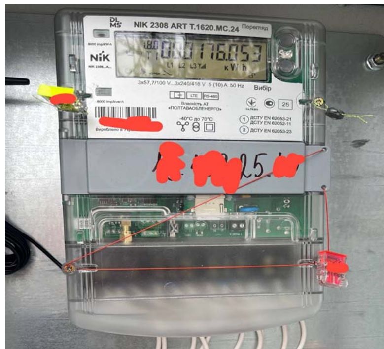
Рисунок 4.1 – Лічильник електроенергії NIK 2308 ARTT.1620.MC.24
